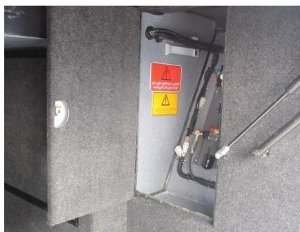
محفظه تابلو باد (داخل جعبه سمت شاگرد)
