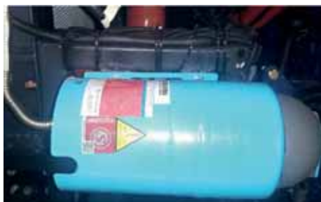
کپسول های اطفاء حریق تیپ ۲
