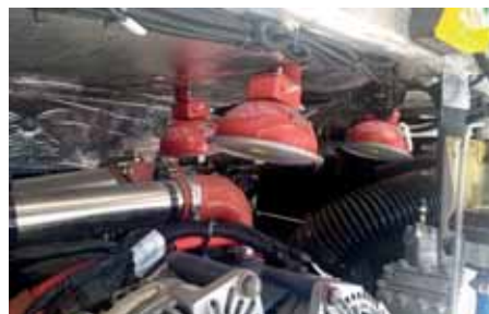
کپسول های اطفاء حریق تیپ ۱
